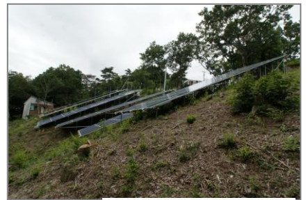
<2号機発電所全容>
