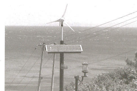
←竜飛崎階段国道にあるHBSソーラー
