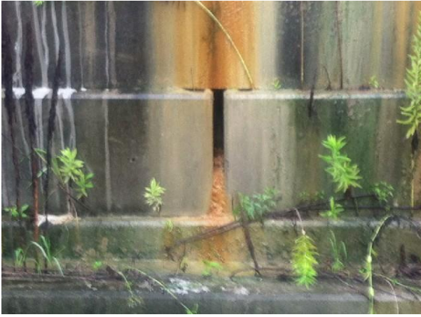
西側擁壁(隙間からの土の流出)
