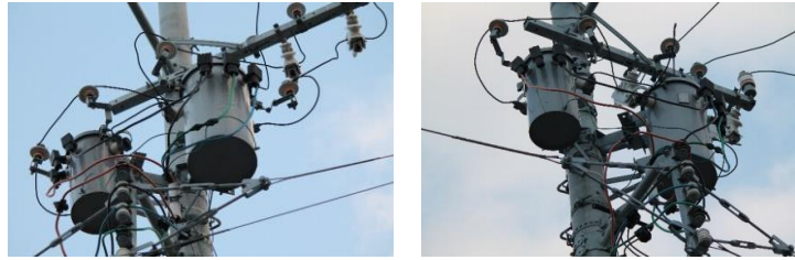
バンク割の事例か確認できないが 2 台の変圧器が併設されている事例
