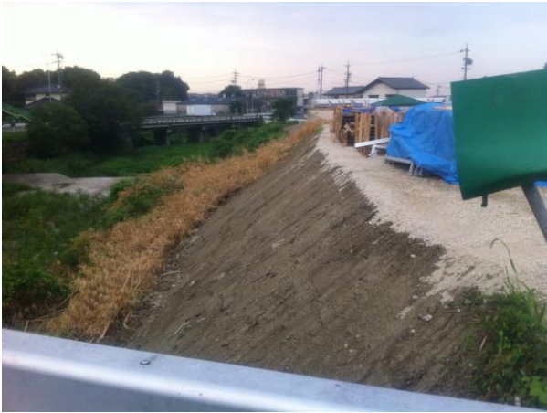
新坂下橋南側(土砂投棄)
