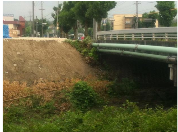
新坂下橋南側(土砂投棄).
