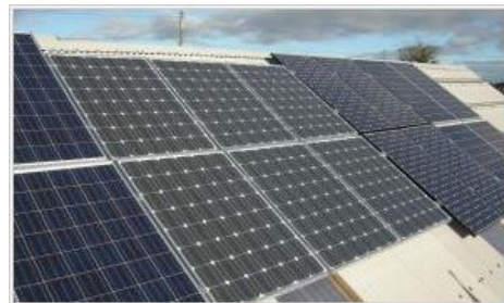
異なるメーカーのパネルを混在させた設置 (ソーラーエッジ社ウェブサイトより)
