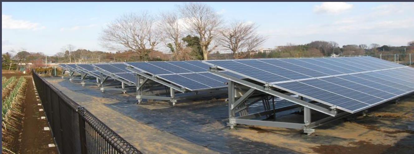
民間太陽光発電所（千葉県流山市）
