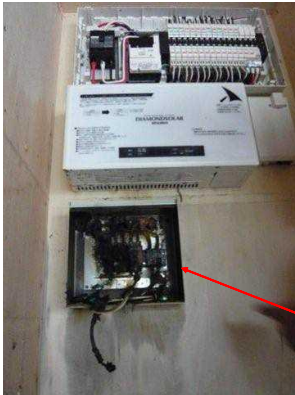
炭化の激しい 接続箱の内部
